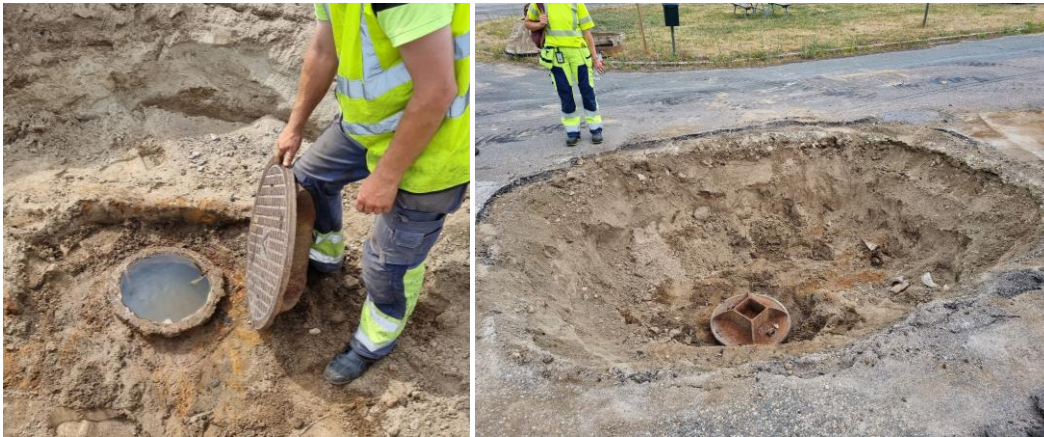
Figur 2 och 3. Visar vattenfylld manlucka med oljeskimmer och markförlagd cistern söder om byggnad 8 och f.d. drivmedelsanläggning (2).
