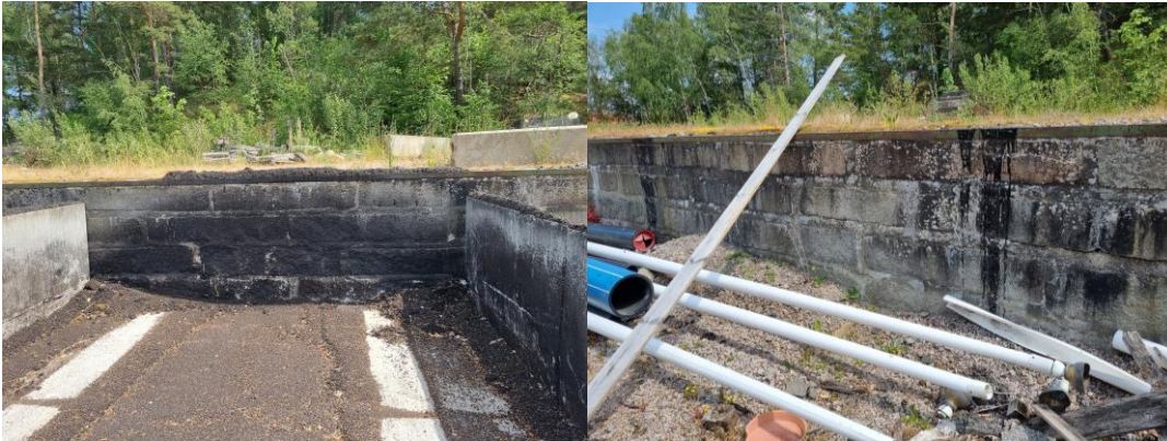
Figur 4 och 5. Svarta asfaltsrester och spill vid fickor för kallasfalt (invid punkt S2309).
